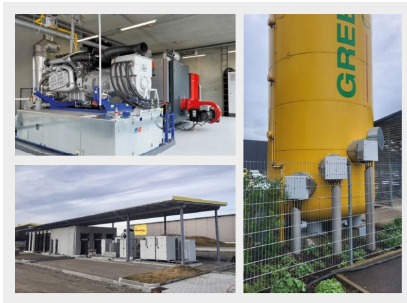
Bild 3. Energiezentrale mit BHKW, Spitzenlastkessel, Pelletkessel (oben links) elektrische Heizelemente im Warmwasserspeicher (rechts) und neue Energiezentrale für Großwärmepumpen mit Batteriespeicher im Vordergrund (unten links)
